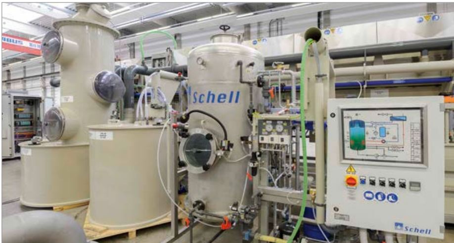
Vakuumverdampfer zur Abwassermeidung
